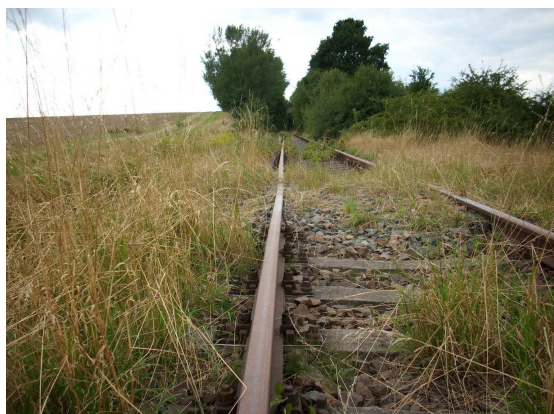
Gleisverwerfung durch einen landwirtschaftlich illegal angelegten Bahnübergang nahe Werdau
